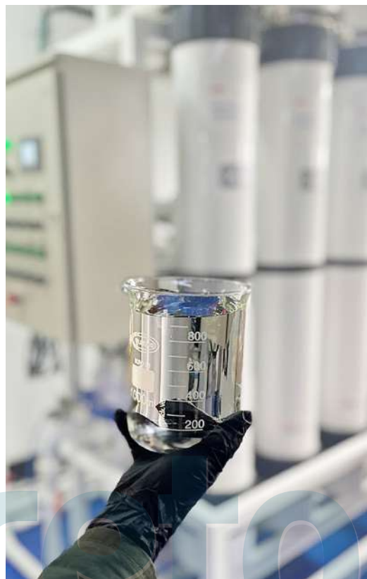
↑ Planta de tratamiento de aguas lluvias en la planta de Sika en Tocancipá.
